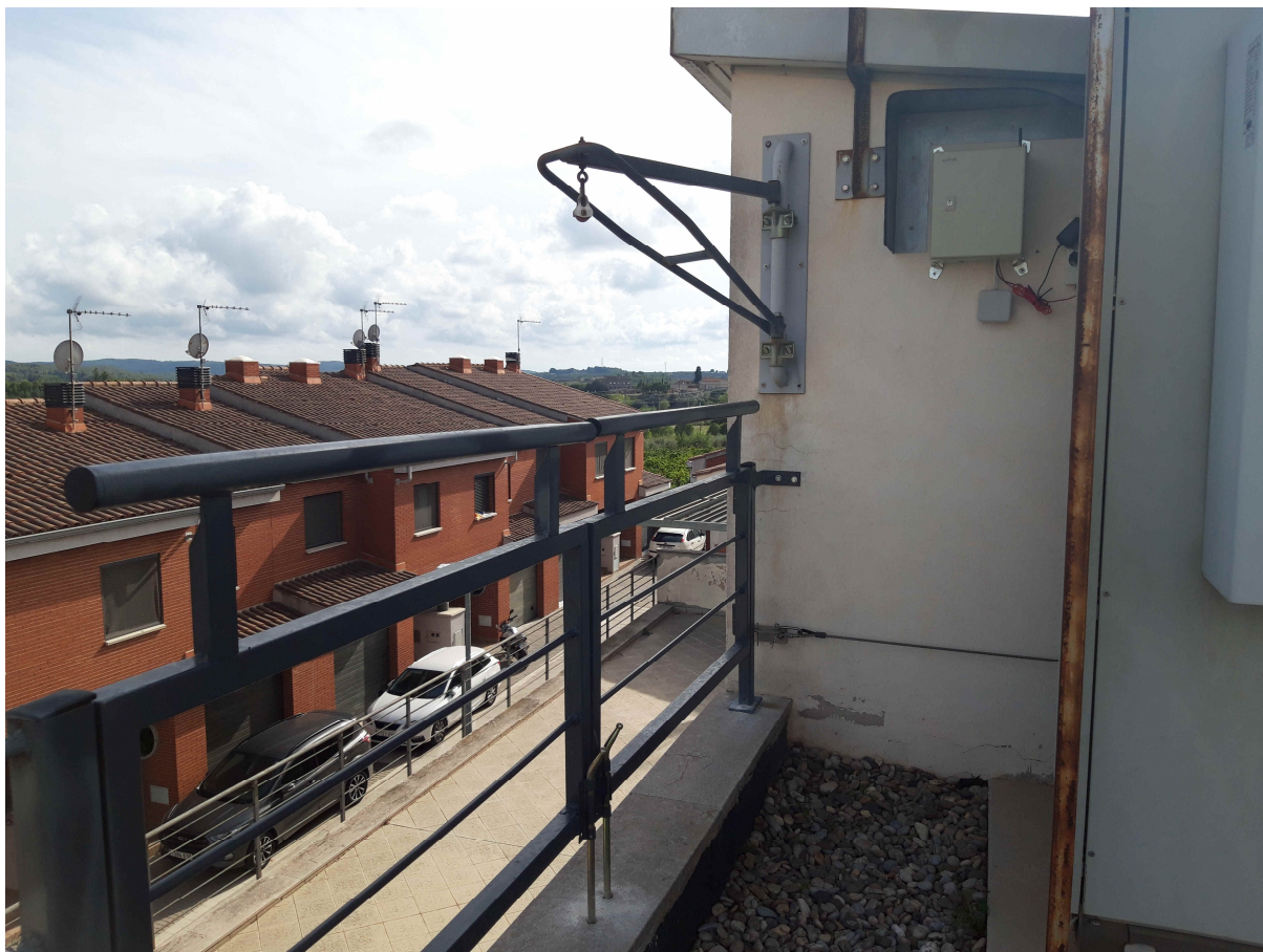
Figura 2. Equip instal·lat a Antistiana.
